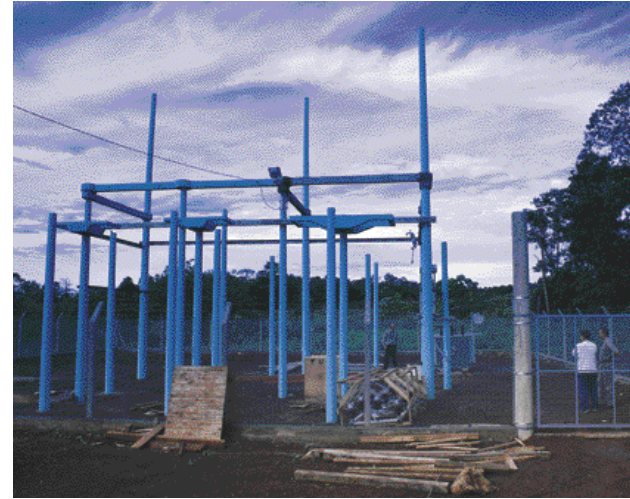
Estación transformadora en Andresito, Misiones.
