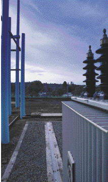
Red de corriente eléctrica en Andresito, Misiones.
