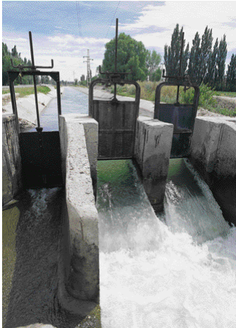
▲ Compuertas y canal revestido en Cipolletti, Río Negro.
