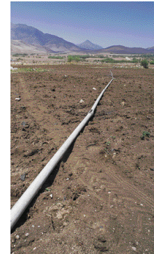
▲ Conducción por tuberías a presión gravitacional, Tafi del Valle. Tucumán.
